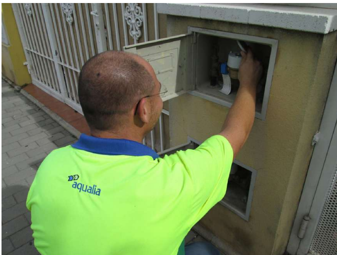
Uno de los técnicos de Aqualia comprobando un suministro
